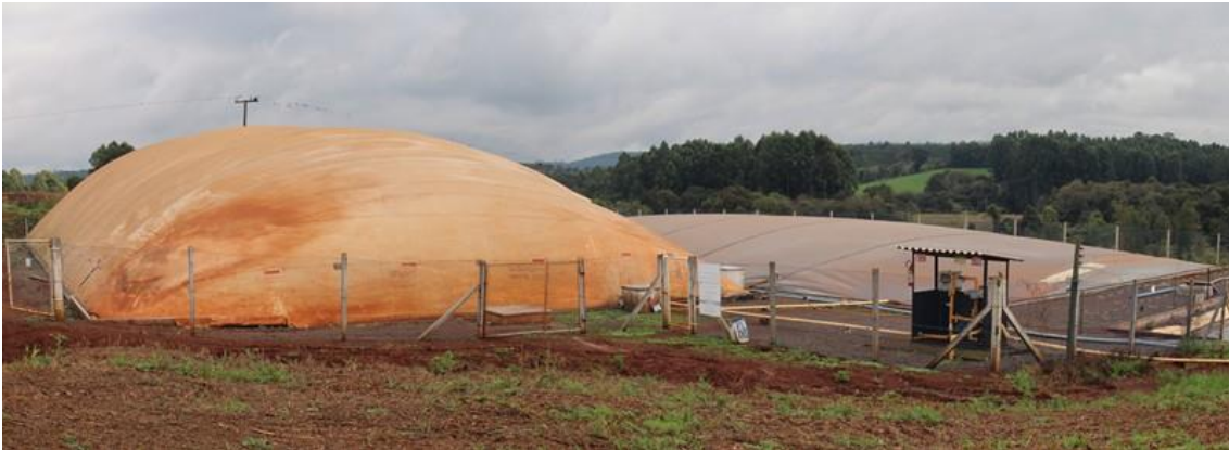
Biodigestor instalado na propriedade de Fabiano Lanznaster
